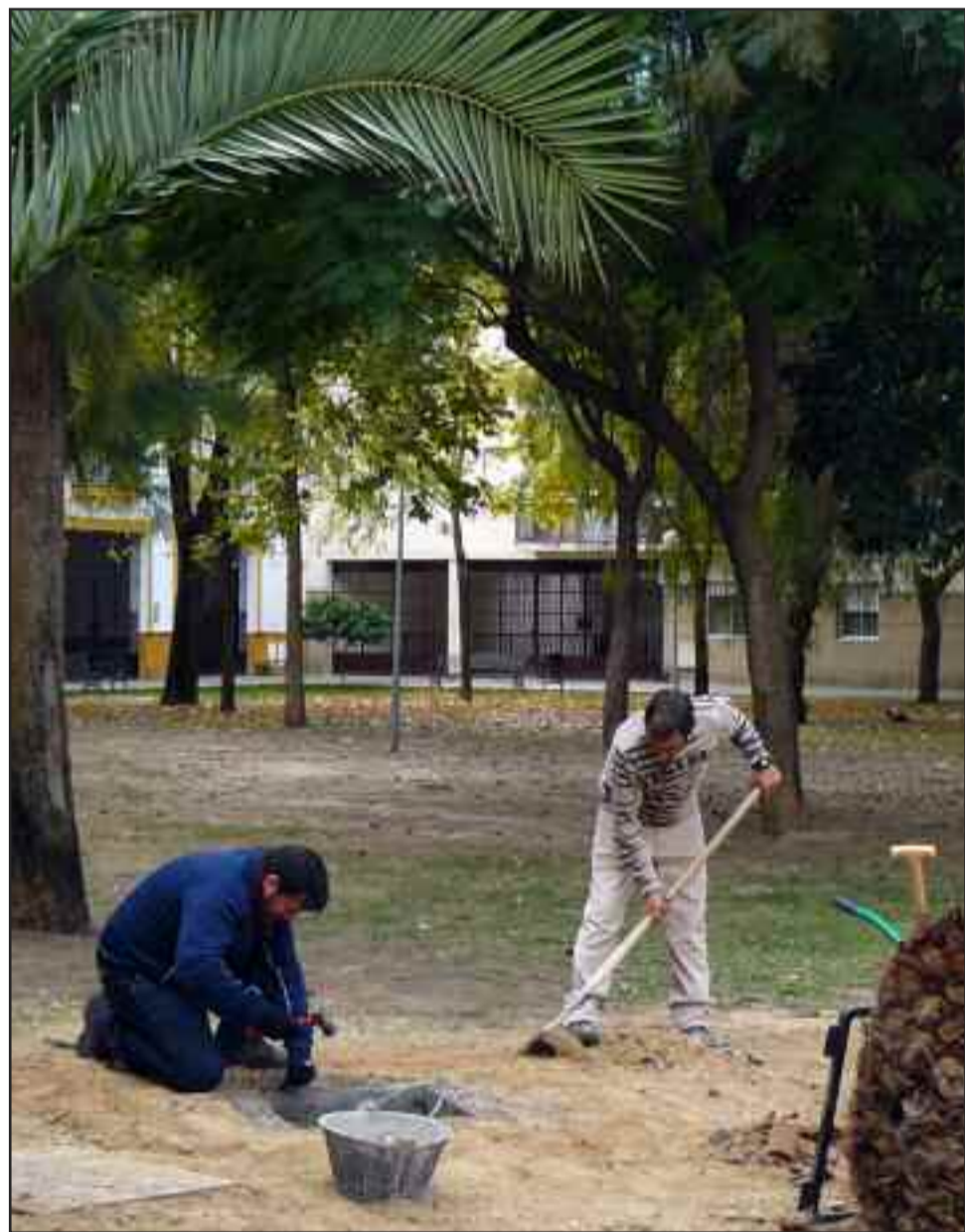
Trabajadores corianos realizando mejoras en una de las plazas de Coria del Río.
